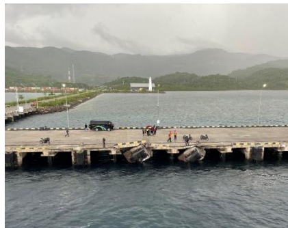
Gambar 6. Kerusakan Fender Dermaga.
